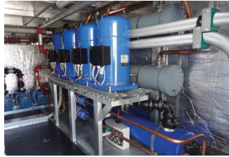
12 Intérieur du SIREG multi compresseurs
