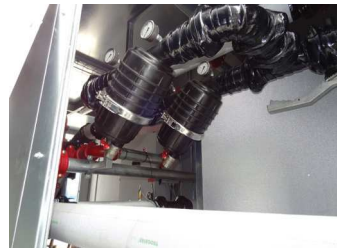
18 Double filtre à eau, PVC + Vannes
