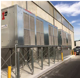
14 2X BRG, batterie sans glycol FAILLARD 01
