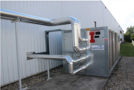
08 Installation GR1C avec système récupération chaleur HES SINTEX NP 69
