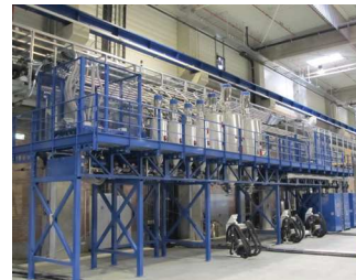
15 Centrale de transport et dessiccation centralisée
