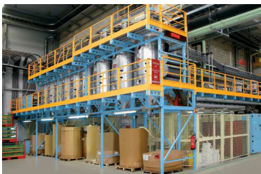
16 Centrale de transport et dessiccation centralisée
