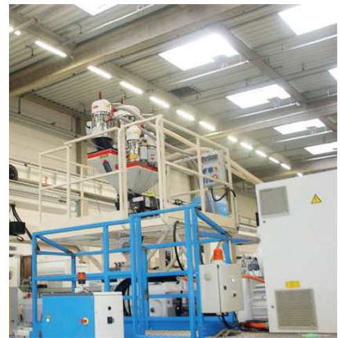
03 INJECTION Doseur pondéral sur presse de gros tonnage 1500T avec plateforme d'accès
