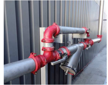
17 Filtre inox 6" + vannes by-pass
