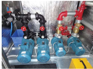
13 Pompes + pompes de sécurité
